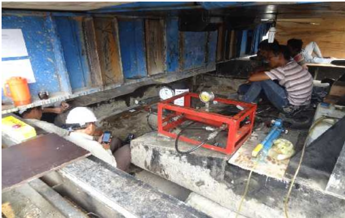
Manometer pengontrol ( pressure gauge ) dan pompa ( pump ) yang digunakan
