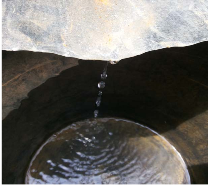
7. Rembesan dinding kanan saluran
