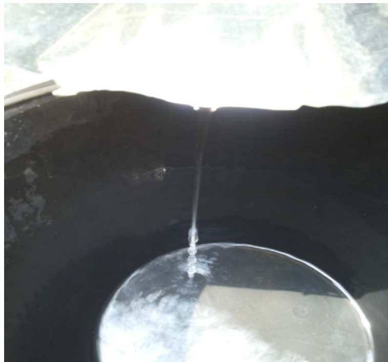
6. Rembesan dinding kiri saluran
